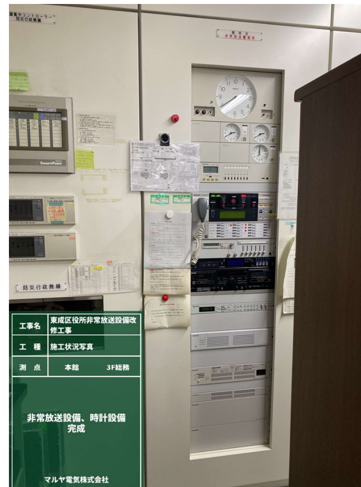
【非常放送設備】
